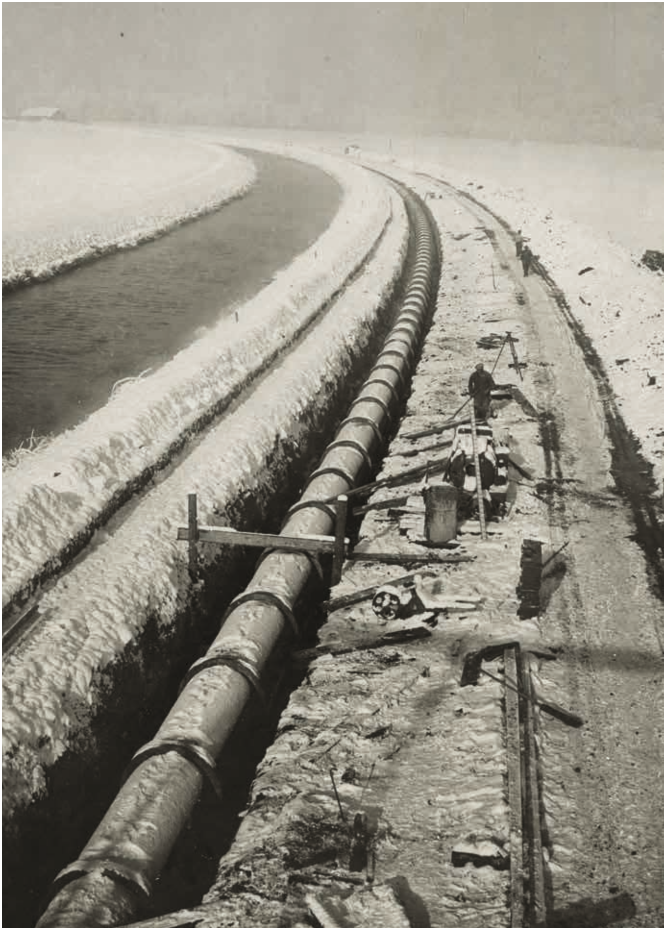
Freispiegel-Leitung der Gürbe entlang.
